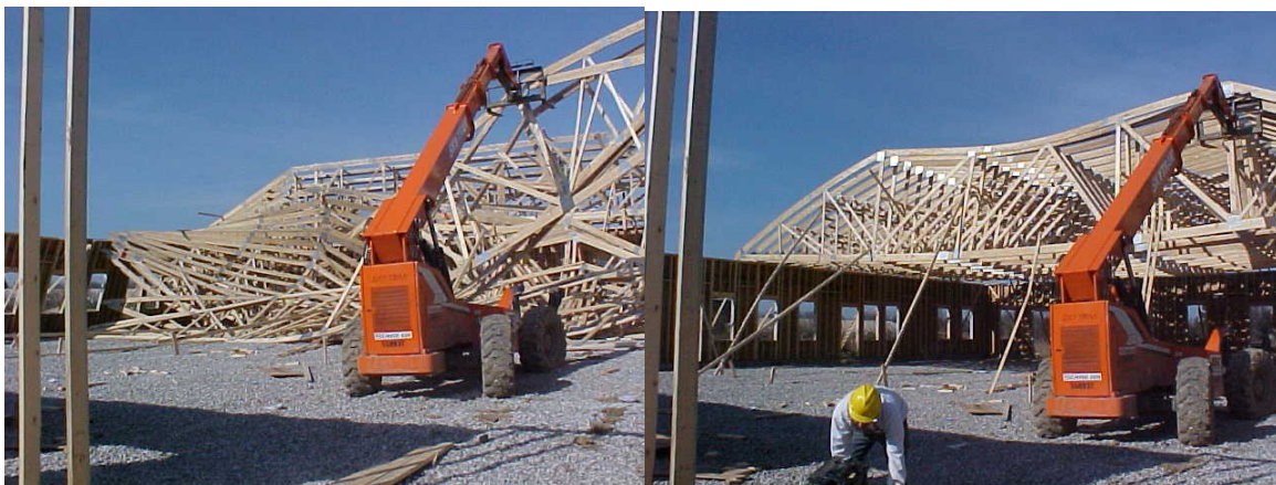
شکل ۱-۵-الف- سقف قبل از نصب.....ب- ریزش سقف
