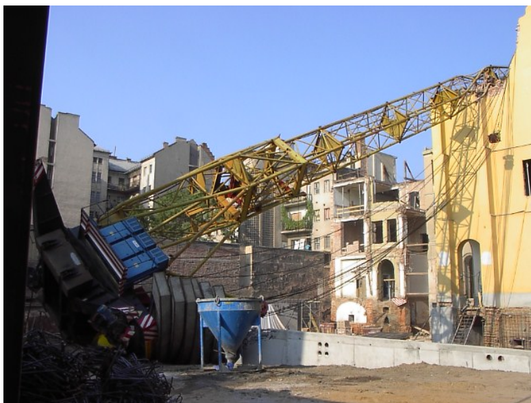
شکل ۳-۶- واژگونی برج بالابر بر روی ساختمان
